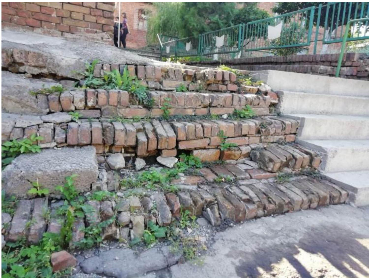
Надзвичайно красиві сходи зруйновані майже вщент. Частина з них замінили бетонними.
